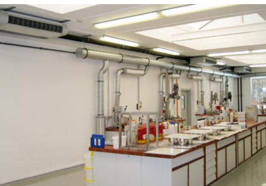
Bild 3: Labor mit Klimakonvektoren
