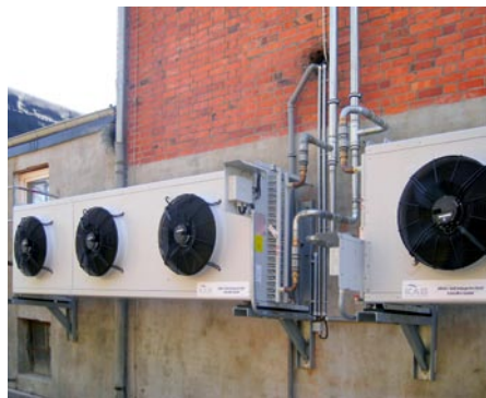
Bild 5: Rückkühler der Adsorptionskältemaschinen mit energiesparenden EC-Ventilatormotoren
